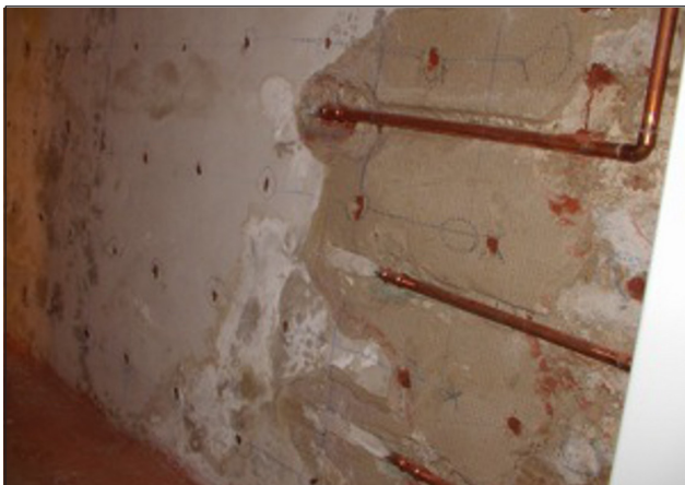
Wand mit Wandheizung und Wasserschäden, teilweise abgefallener Putz ist die (Neben-) Wirkung nach 9 Monaten
